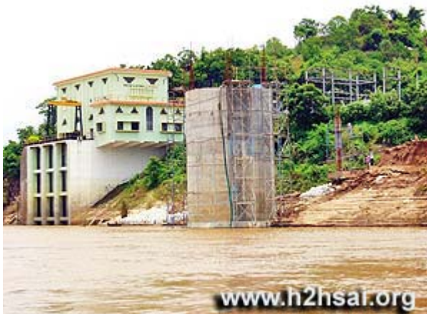
In Ansaugstationen wie dieser hier wurde Flusswasser gesammelt (Die Aufnahmen entstanden während der Bauarbeiten)
